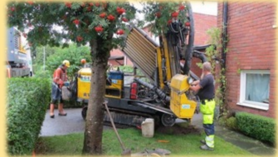
写真：スウェーデンの一般家庭の庭で地中熱ヒートポンプの設置を行っている
