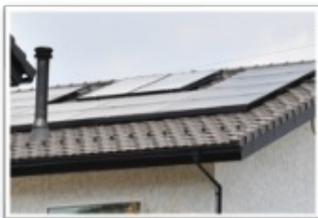
太陽光パネルと太陽熱温水器パネル
